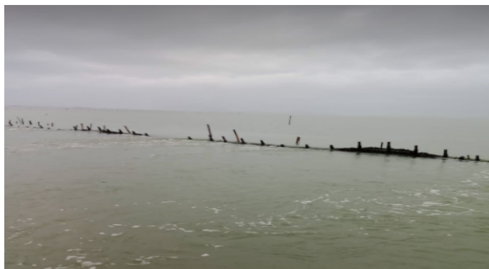
Φωτ. 1. Ζημιές από την κακοκαιρία “Μπάλος” (Οκτώβριος 2021) στους ιχθυοφραγμούς του μετώπου της Κεντρικής λιμνοθάλασσας.
